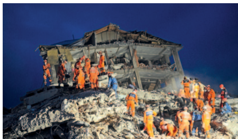
Helfer auf den Trümmern eines eingestürzten Hauses in Elazığ in der Türkei. Für die Erdbeben-Opfer spendeten bei Flender Unternehmensführung wie Belegschaft gleichermaßen. (Foto: Mehmet – stock.adobe.com)
