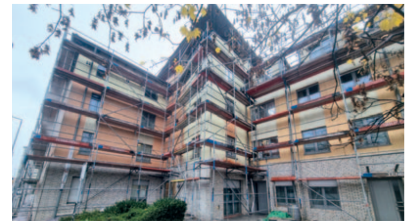
Bei der Sanierung wurde der untere Teil des Hauses mit mineralischer Dämmung und Klinkersteinen versehen; der obere Teil des Gebäudes wurde weiß gestrichen. (Bild: Probst)
