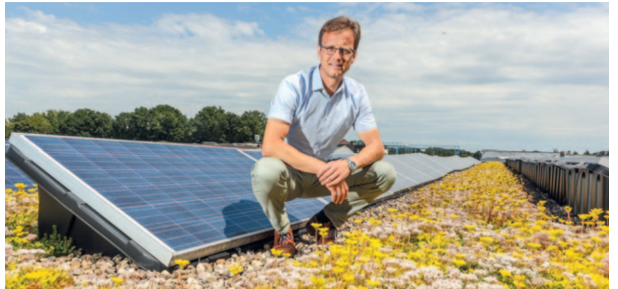
490 kWp Photovoltaik inklusive Dachbegrünung auf den Hallendächern des Maschinenbauers Spaleck GmbH & Co. KG in Bocholt: Das ist eine von vielen Maßnahmen von Geschäftsführer Carsten Sühling, um den CO 2 -Fußabdruck zu verringern. Mit Erfolg: Trotz starken Wachstums sank der Ausstoß des Treibhausgases in den vergangenen fünf Jahren um 60 Prozent. (Alle Fotos: Spaleck)
